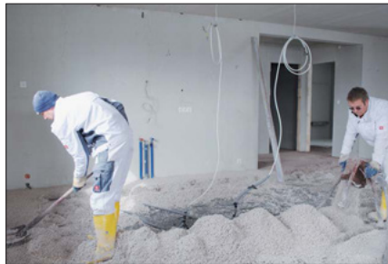
2. ThermoWhite® wird vor Ort gemischt und mittels Förderschlauch in das Haus befördert.
